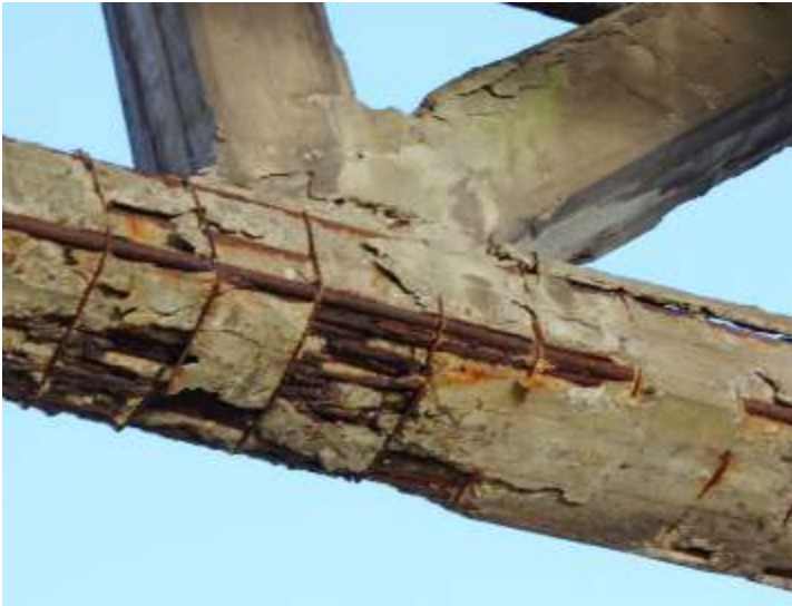
Degrado dei materiali
