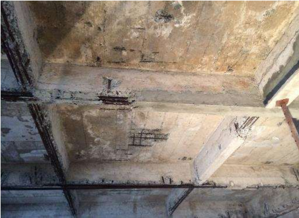
Deterioramento armatura longitudinale
