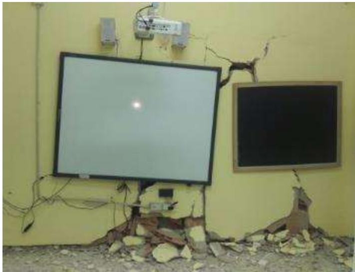
Parete non rinforzata danneggiata dal sisma
